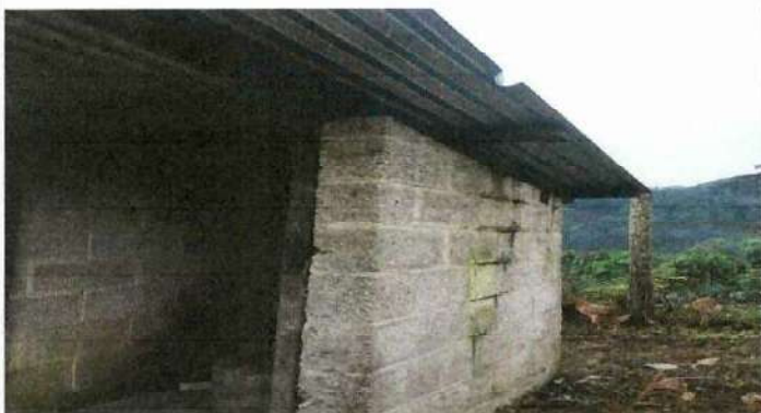
Foto 3: Se observa las letrinas en mal estado
