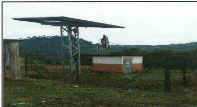
Foto 2: Se observa el la caseta donde se encuentra el inversor en mal estado.
