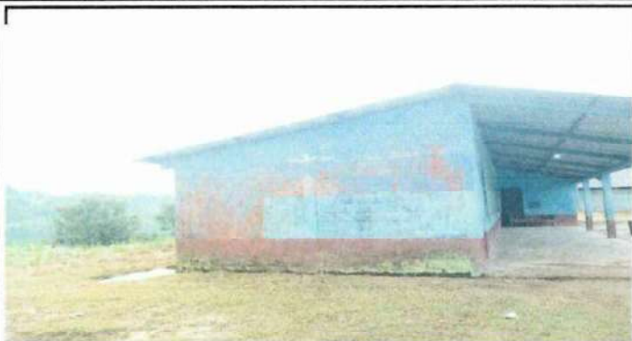
Foto 1: Se observa el deterioro de la pintura de las paredes.
